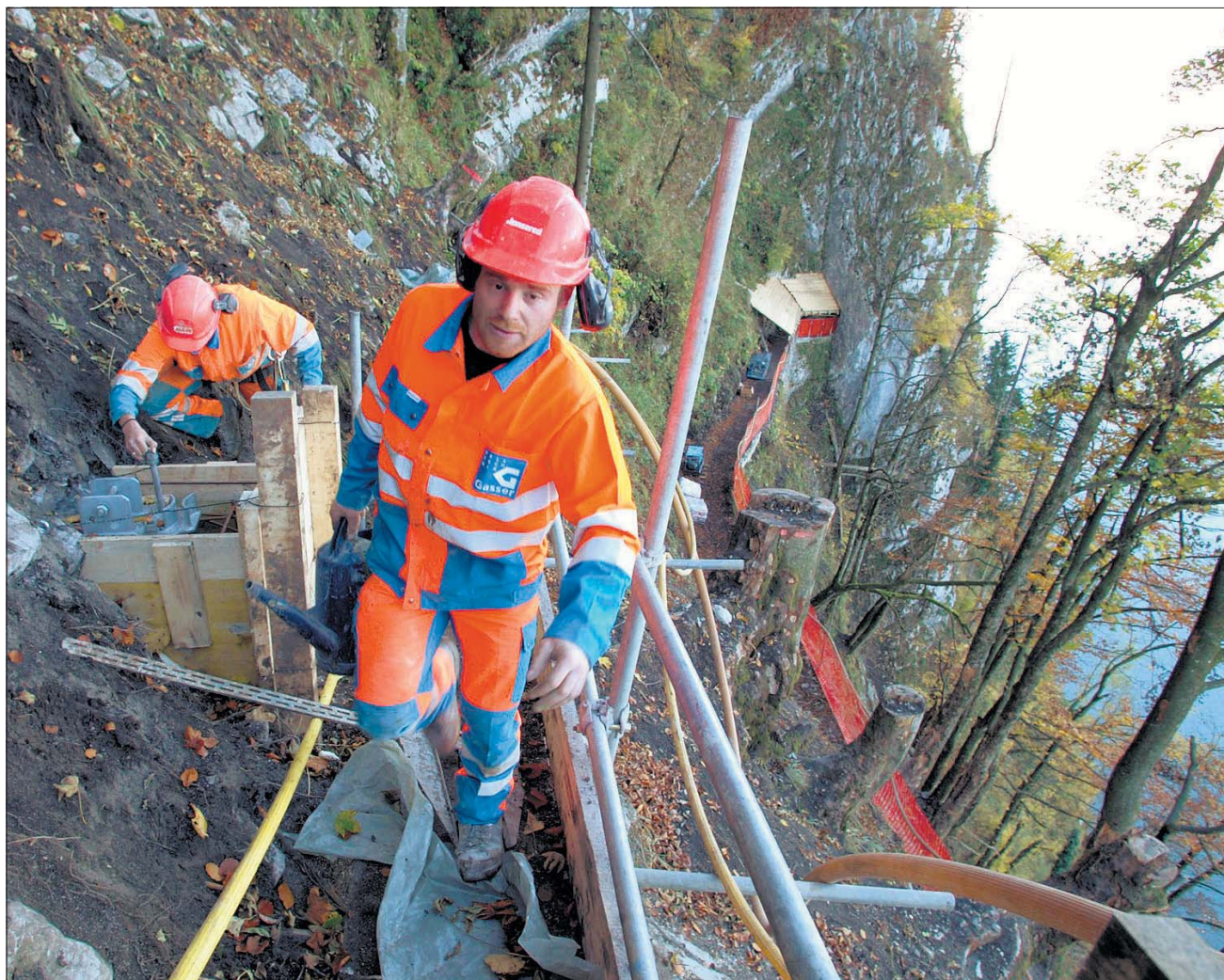
Eine Baustelle in der Felswand: Bruno von Moos und seine Kollegen arbeiten in luftiger Höhe am Bürgenstock.
